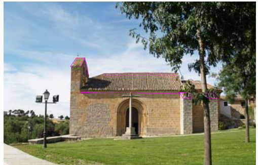
Faldón Sur. Sin alineación alero y cumbrera. Cubierta de espadaña y contrafuertes a tratar.
