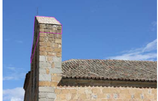
Estado actual de la cubierta de la espadaña.
