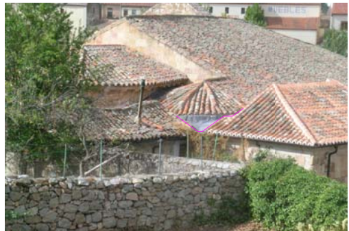
Encuentro conflictivo entre el ábside Norte y planta superior de casa del santero
